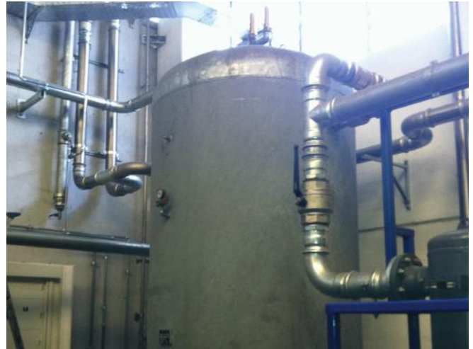
Serbatoio aria compressa
